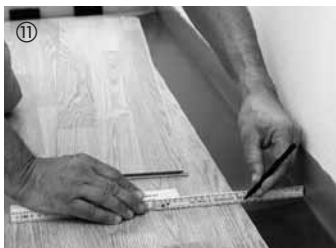
⑪ Elementerne i sidste række skæres til i længderetningen med en ekspansionsafstand på 10–15 mm og indpasses.
