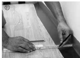
11 Die Elemente der letzten Reihe werden an der Längsseite unter Berücksichtigung eines Dehnungsabstandes von 10–15 mm zugeschnitten und eingepasst.
