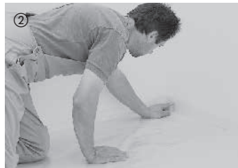
② Ved cementgulve og ved udlægning på gulvvarme skal der principielt lægges en 0,2 mm tyk PE-folie, som skal overlape 30 cm i kanten. Folien trækkes op ved væggen og skæres efter montering af fodlister af ved overkanten af disse.
