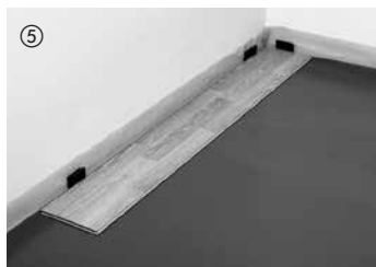
⑤ Lægningen startes i højre hjørne af rummet. Elementerne lægges med federsiden mod væggen og fikseres med afstandskiler (ekspansionsafstand til væg 10–15 mm).
