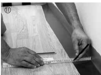
⑪ Prvky poslední řady se při zohlednění dilatačního odstupu 10–15 mm přířízne na podélné straně a zapasují se.
